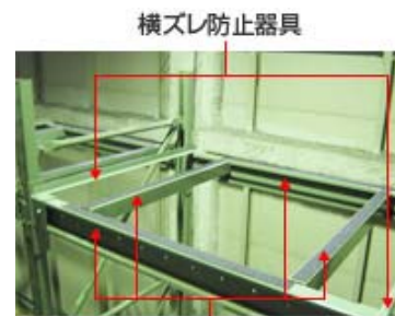
落下防止を施した、パレット保管設備
